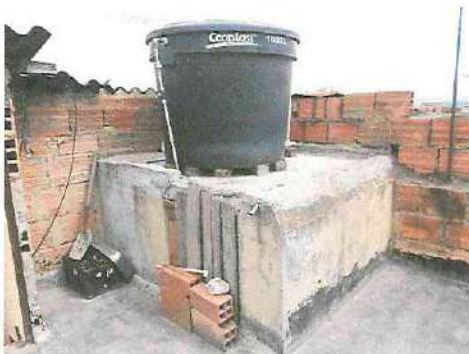
M8: Deposito De Concreto Y Bloque En Terraza
