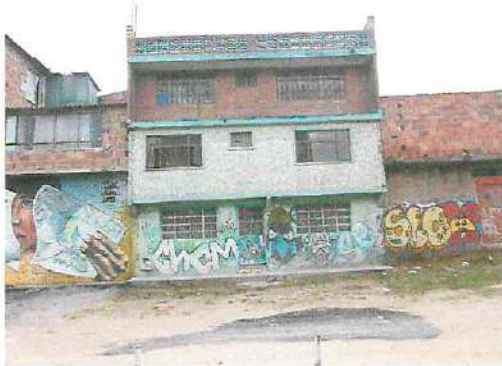
Fachada Carrera 5 (Corredor Férreo). M10: Placa Volada Concreto Fachada Posterior.
