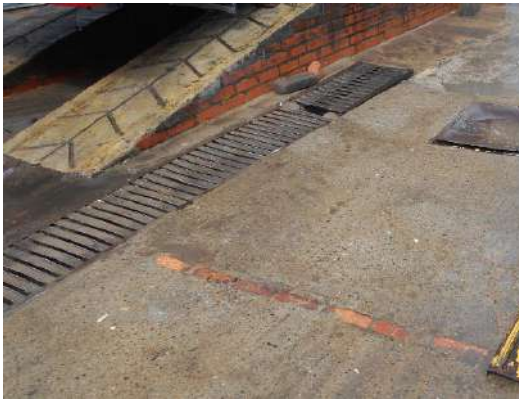
M8 Cárcamo Con Rejilla Metálica #1
