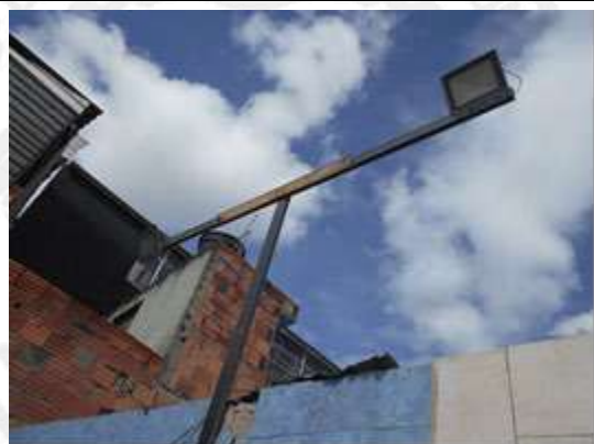
M1 Estructura De Iluminación
