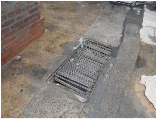
M14 Cárcamo Con Rejilla Metálica #2
